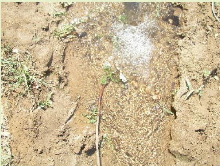
Photo 5 : Mise en évidence du départ des éléments fins du sol
